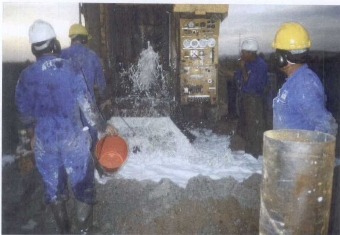
Caudal que surge a partir de los 69 m.
